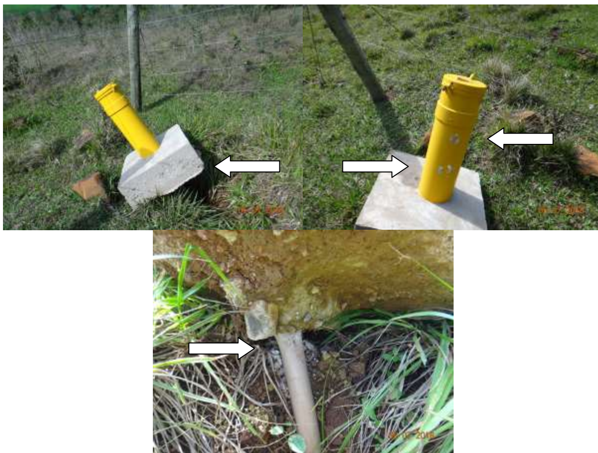
Figura 16 – Piezômetro (PMNA-6A) danificado.
