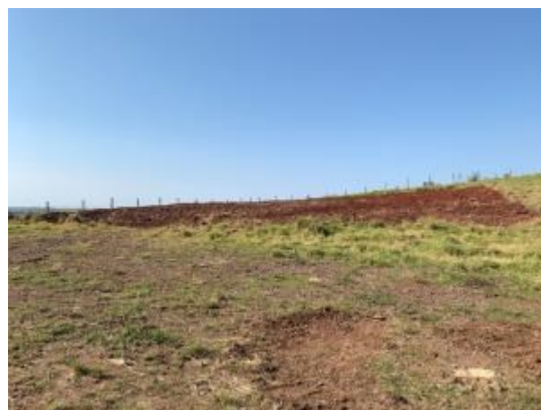
Baia de contenção desmobilizada.
