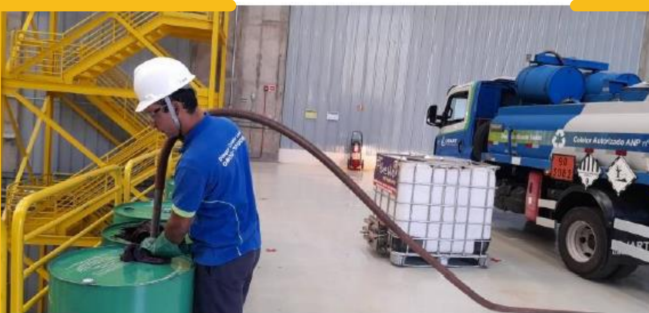
Coleta de óleo contaminado - casa de força
