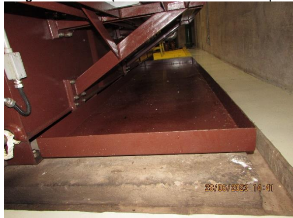
Figura 21 Contenção de óleo unidade hidráulica sem presença de óleo
