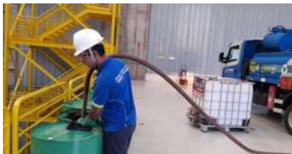
Coleta de óleo contaminado casa de força
