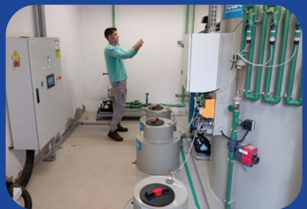
Monitoramento mensal da qualidade da água tratada na ETA
